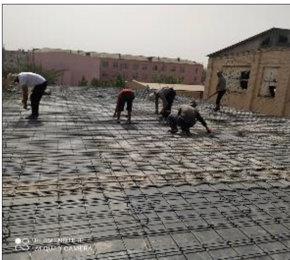
Фото 17: КС-01: Рабочие не использовали СИЗ, сентябрь 2022 года
