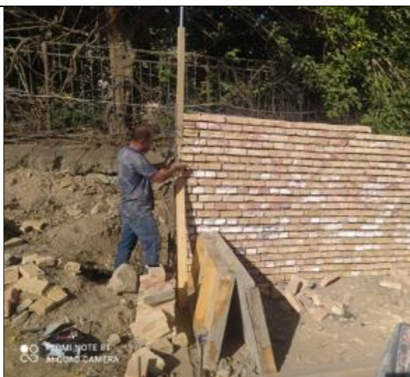
Фото 18: КС-03: Рабочие не использовали СИЗ, сентябрь 2022 года
