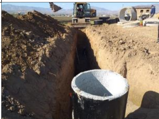
Фото 20: СВ05/2: траншеи не огорожены, декабрь 2022 г.
