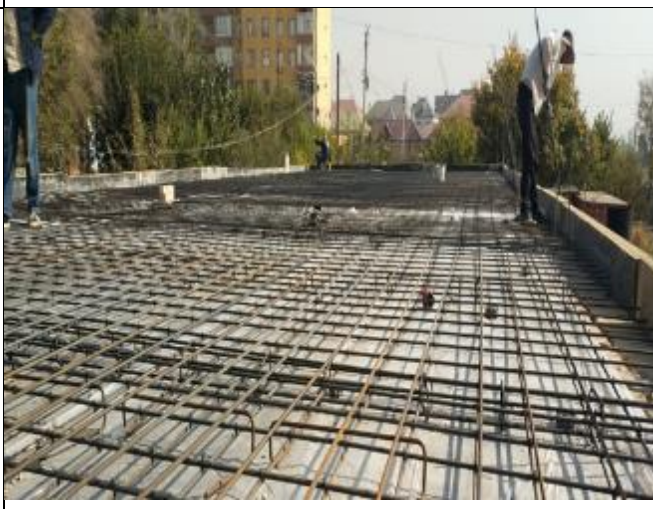
Фото 8: Установка арматуры для монолитного перекрытия в здании цеха, рабочий не обеспечен СИЗ, сентябрь 2022 года
